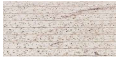
Stockflecken/Schimmel auf der Oberfläche
